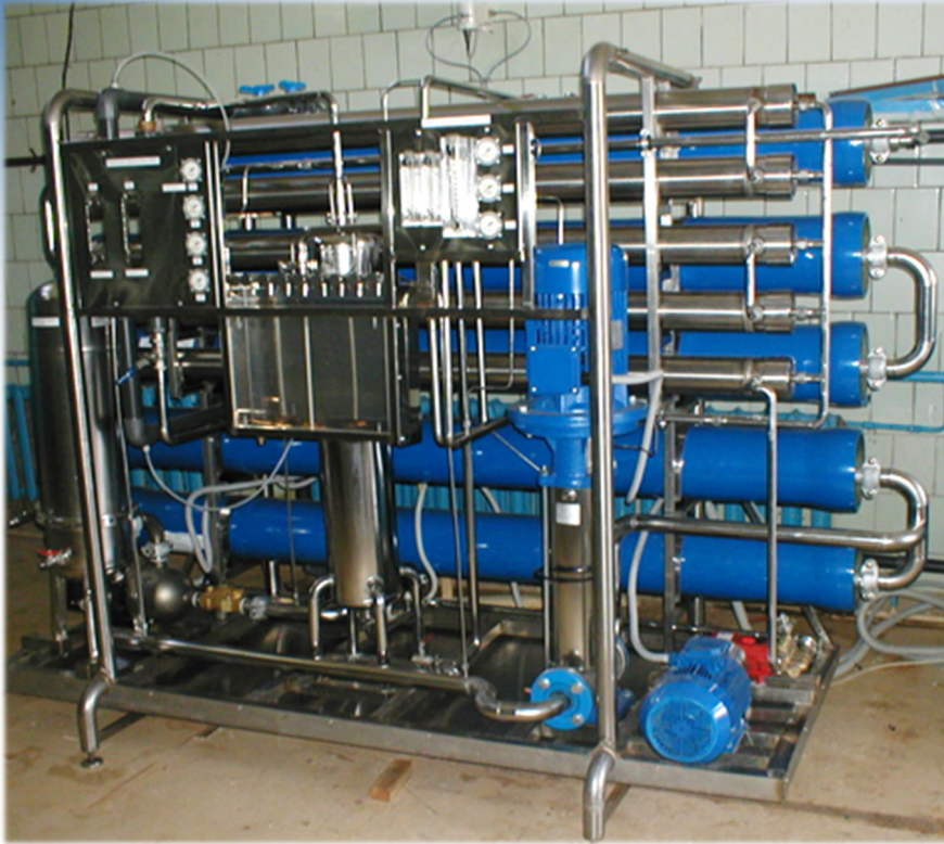
Установка рекуперации деминерализованной воды из низкоактивных жидких радиоактивных ОТХОДОВ
