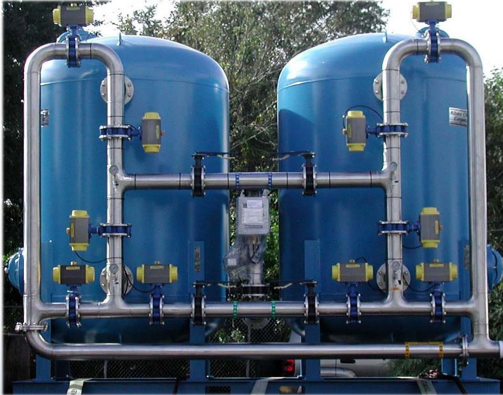
Станция ионообменного удаления солей жесткости (Н – катионирование), 50 м 3 /час
