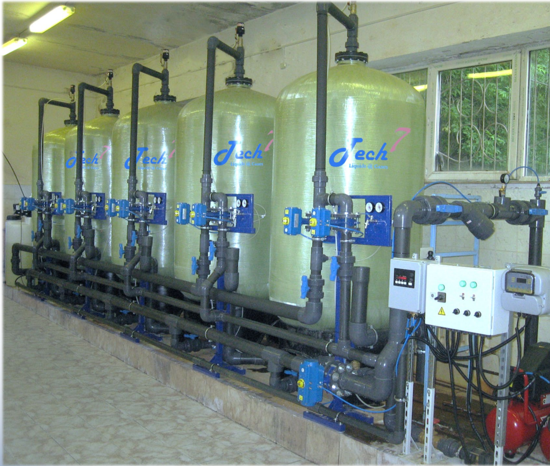
Установка обезжелезивания воды 1500 м 3 /сут; «Сочи-2014»
