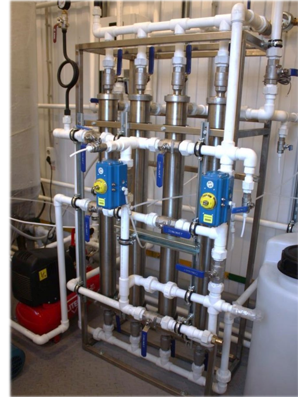
Установка ультраfiltrации 20 м 3 /сут
